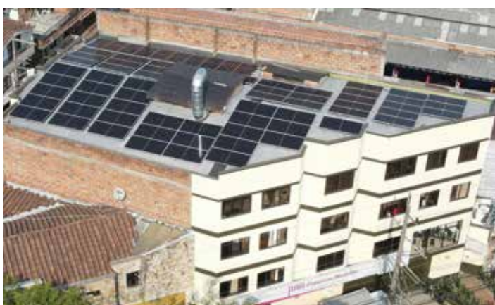
Plásticos Medellín - 41 kWp
