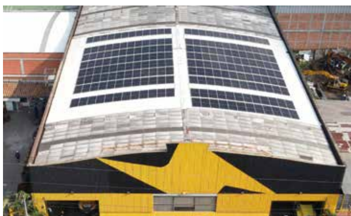
G&J Sabaneta - 120 kWp
