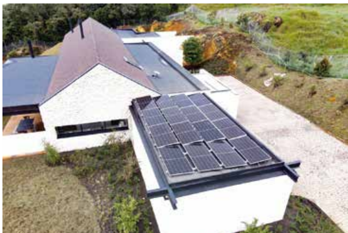
Casa Alto de las Palmas - 10 kWp
