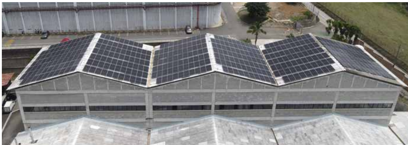
HWI - 242 kWp - PPA
